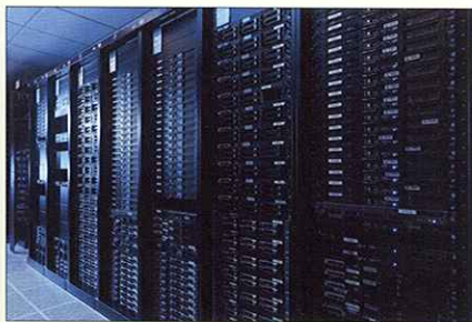
Data center do UOLDIVEO: em busca de eficiência e confiabilidade
